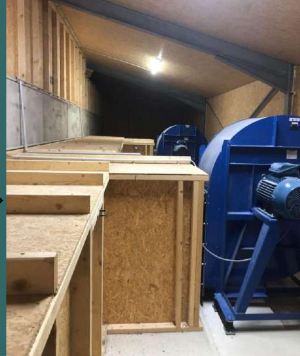
Séchage en bâtiment via la ventilation d'un air à température ambiante ou réchauffé
